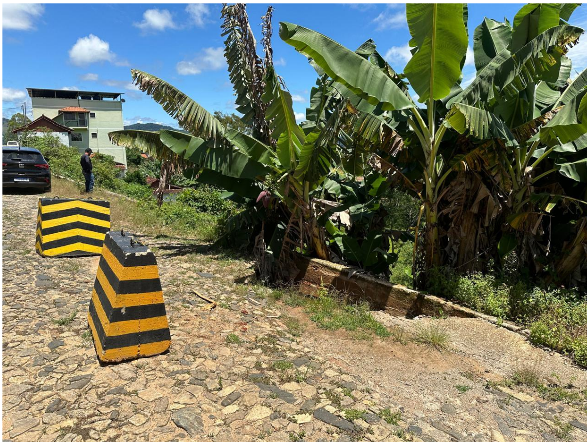
Local onde será executada o muro de arrimo e o reforço do muro de arrimo existente.
