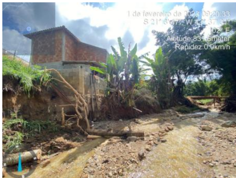
Foto 04: Ponte de Concreto totalmente danificada.
