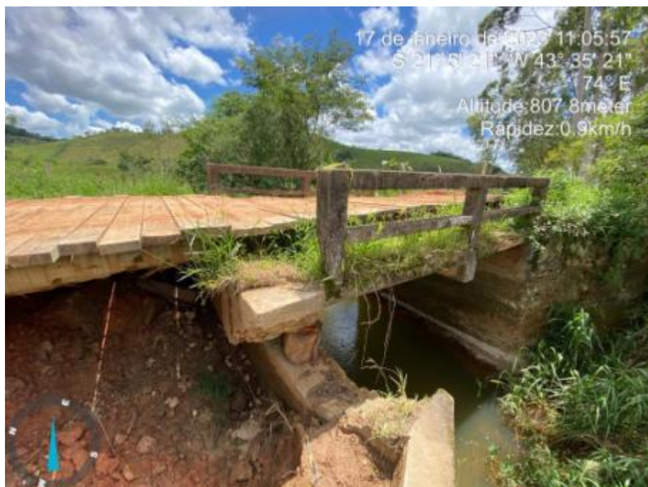
Foto 02: Ponte de Concreto totalmente danificada.
