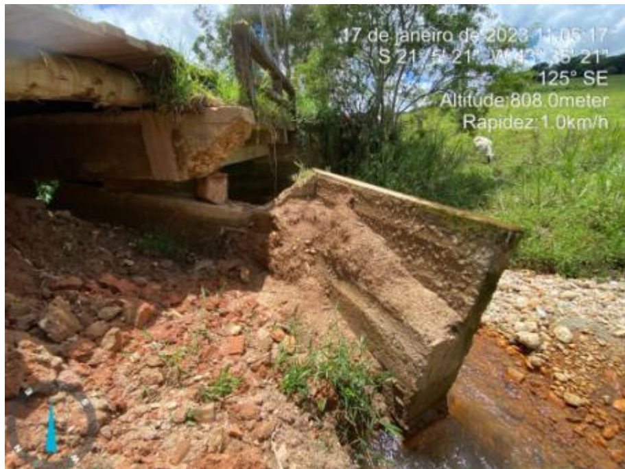
Foto 03: Ponte de Concreto totalmente danificada.
