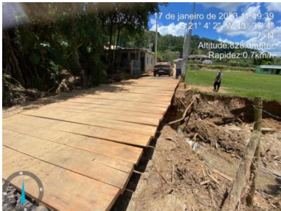
Foto 02: Ponte de Concreto totalmente danificada.
