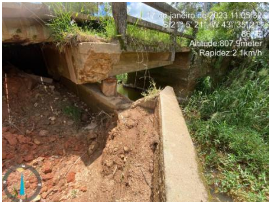
Foto 04: Ponte de Concreto totalmente danificada.
