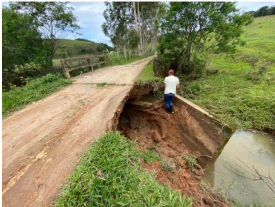
Foto 01: Ponte de Concreto totalmente danificada.
