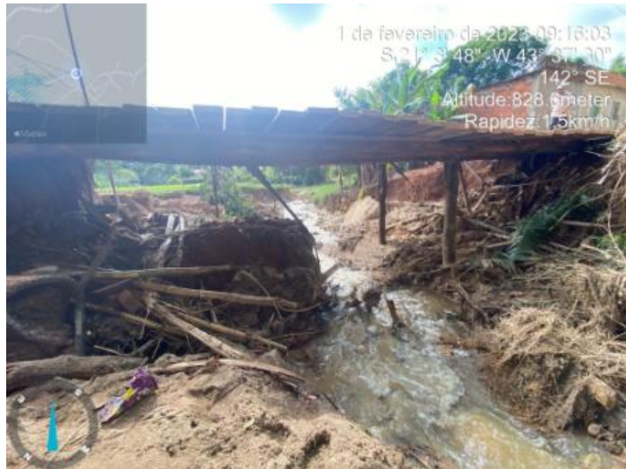
Foto 03: Ponte de Concreto totalmente danificada.
