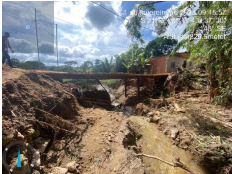
Foto 01: Ponte de Concreto totalmente danificada.
